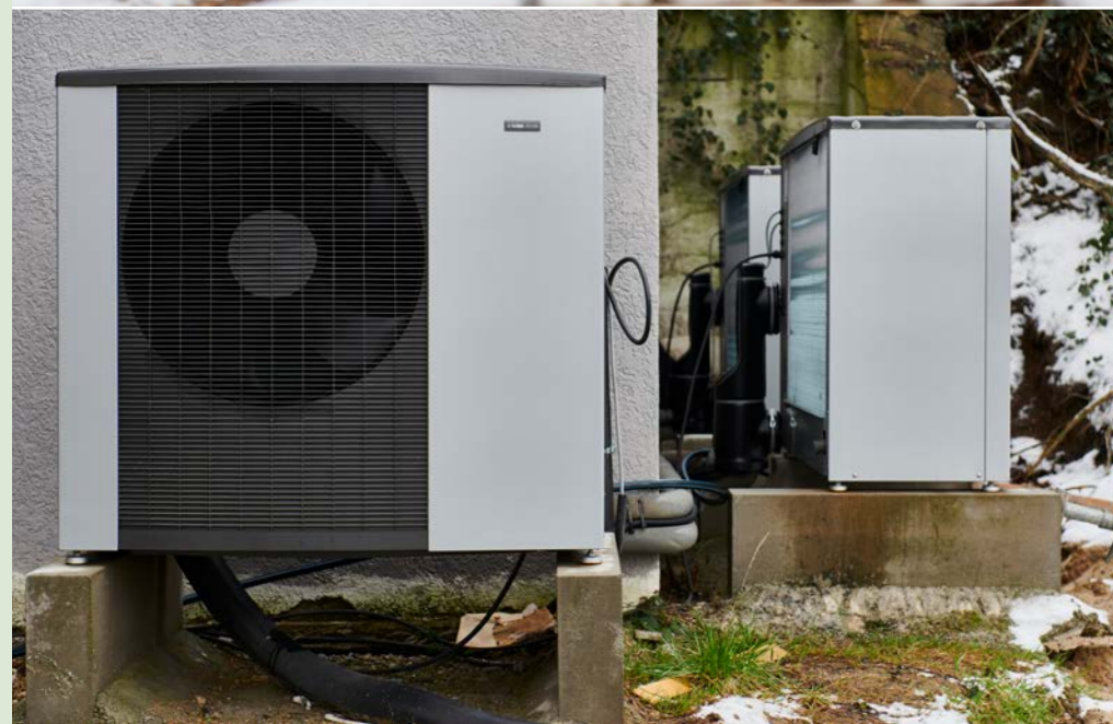
Die drei Außeneinheiten der Luft/Wasser-Wärmepumpen NIBE F2120 mit 16 KW arbeiten in einer 3-fach Kaskade.
