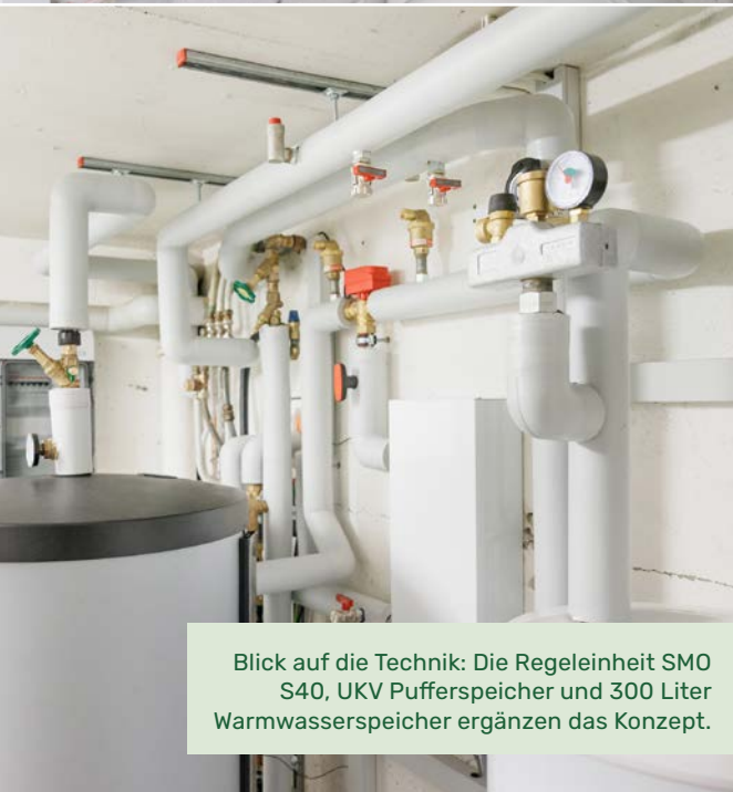
Kompakte Lösung im Heizungskeller.
