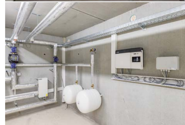
Jede Wohnung ist mit einer Fußbodenheizung ausgestattet.
