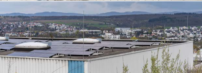
Auf dem Dach der Halle von BCW ist eine große Photovoltaik-Anlage installiert – der dort erzeugte Strom kann mit für den Betrieb der Wärmepumpe genutzt werden.
