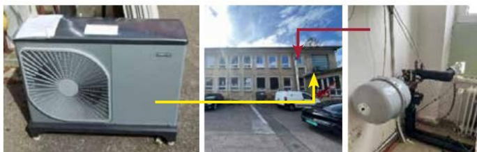
Obr. 3 Tepelné čerpadlo NIBE F2040-6 s vyznačením technické místnosti
